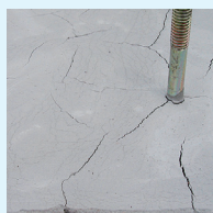
基礎天端(レベリング材)にクラックが入っている様子 夏場には既設コンクリートに水分を奪われたり、乾燥収縮でクラックが入ることが多い
