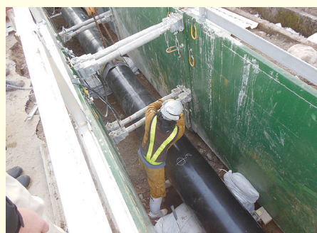
GPL土留：ガスパイプライン
